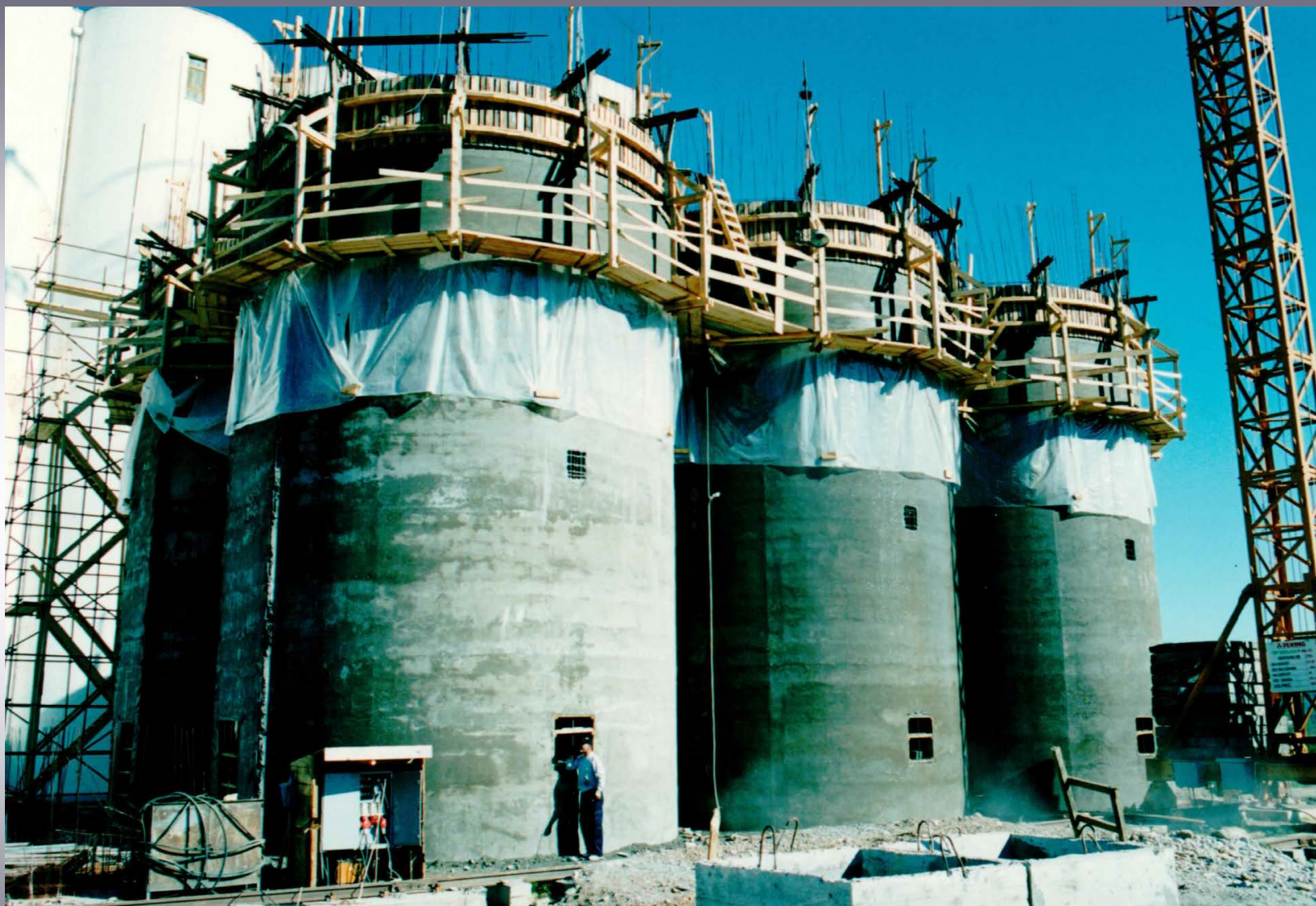
ĆELIJE SILOSA U TOKU "KLIZANJA"
